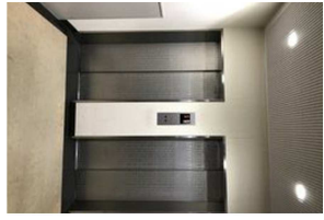
002エレベーター
